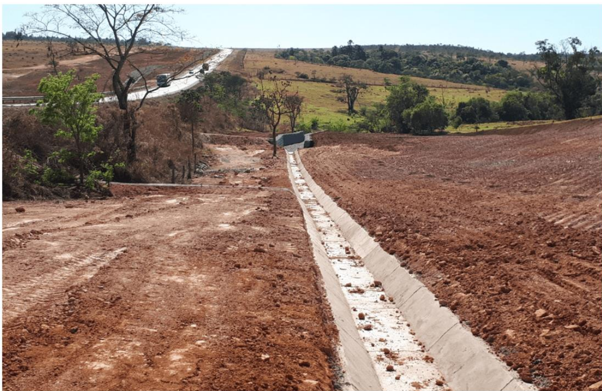
Figura 3 – Serviços topográficos, construção de dispositivo de drenagem, recomposição do solo e revegetação
