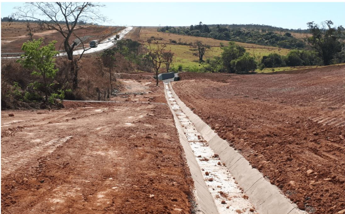
Figura 3 – Serviços topográficos, construção de dispositivo de drenagem, recomposição do solo e revegetação
